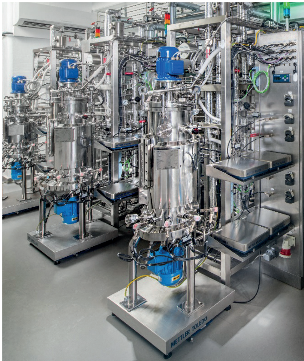
Bioreaktoranlage des Fachgebiets Bioverfahrenstechnik
